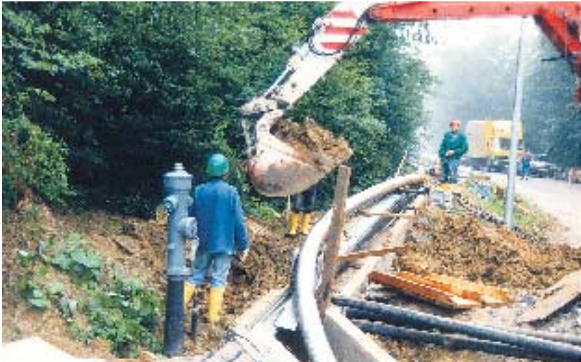
Transferleitung für Ariane Teststand Transfer Line for Ariane teststand
