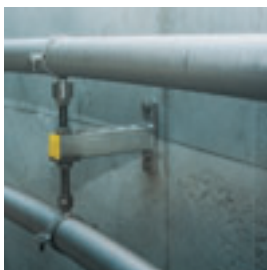
Befestigung im Behälter (Fermenter)
