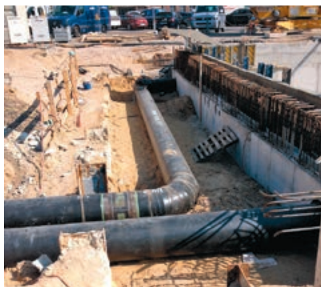
Anschluss an die Kühlzentrale
