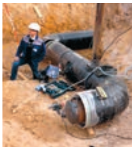
Zerstörungsfreie Druckprüfung vor Ort
