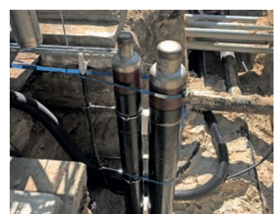
Ordnungsgemäße Sicherung und Befestigung der Anschlüsse
