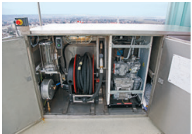
Betankungsanlage mit Jet A-1
