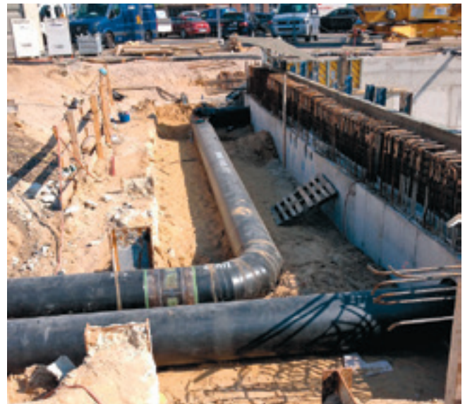
Anschluss an die Kühlzentrale
