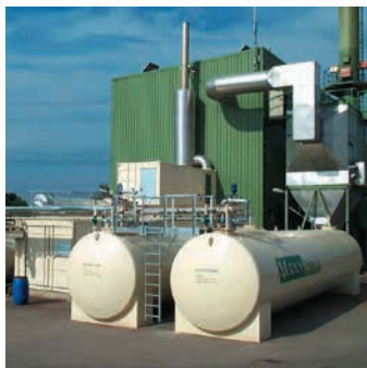
im Tank zur Wärmeübertragung
